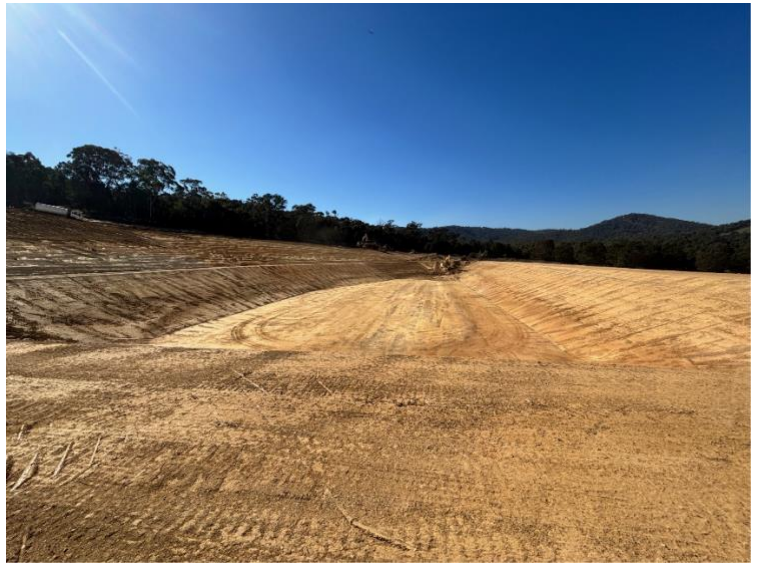
Abbildung 2. Vorbereitungen für den 17-Megaliter-Stausee, Blick nach Osten, Beachten Sie den Bagger als Maßstab, 30. April 2026.
